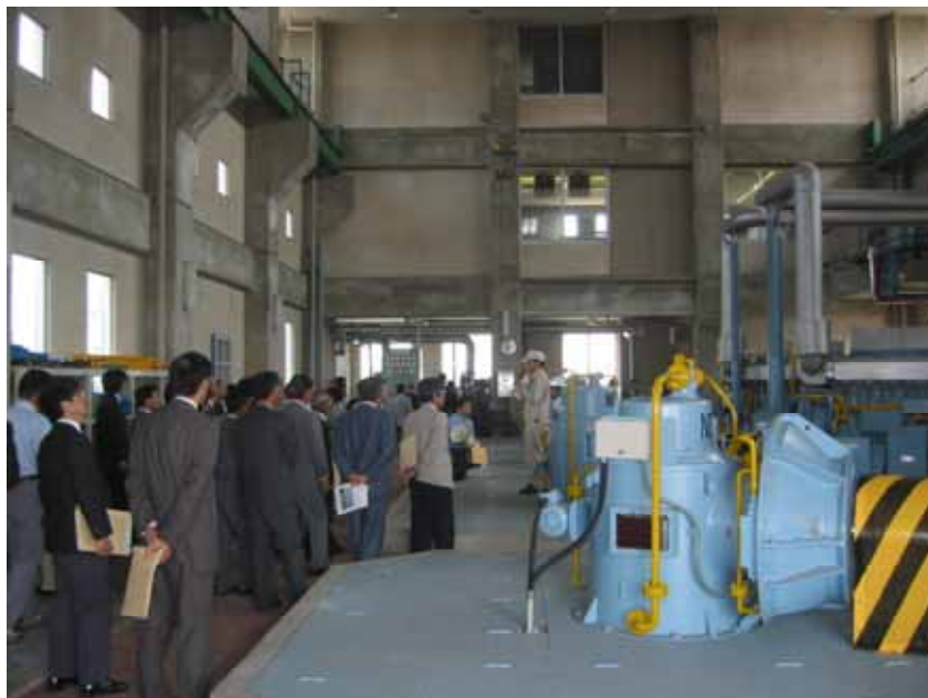
早田川排水機場(平成14年5月27日)
