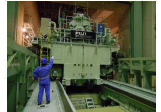
燃料出入設備の動作試験 (平成29年10月～)
