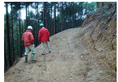
施工後に自然沈下した盛土部
