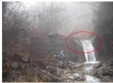
破損状況（中津川市中津川前山）
