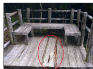
施設の破損状況（美濃加茂市）
