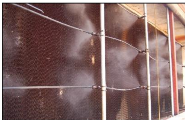
畜舎壁面に設置されたクーリングパッド
