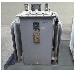
変圧器（トランス）
