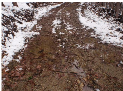
行き場のない路面水
