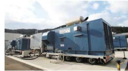
高圧電源車(1,825kVA, 3台)
