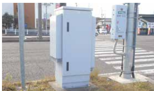
信号機電源付加装置
