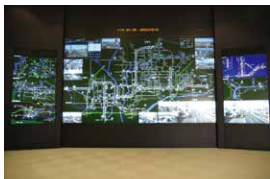
交通管制センター
