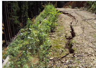
【作業道 重根洞線】 H21被災現場 補修前 ※H21作業道研修箇所
