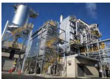
木質バイオマス発電施設（瑞穂市）
