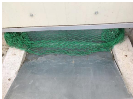
鶏糞ベルト接合部の隙間を亀甲網で塞いだ例
