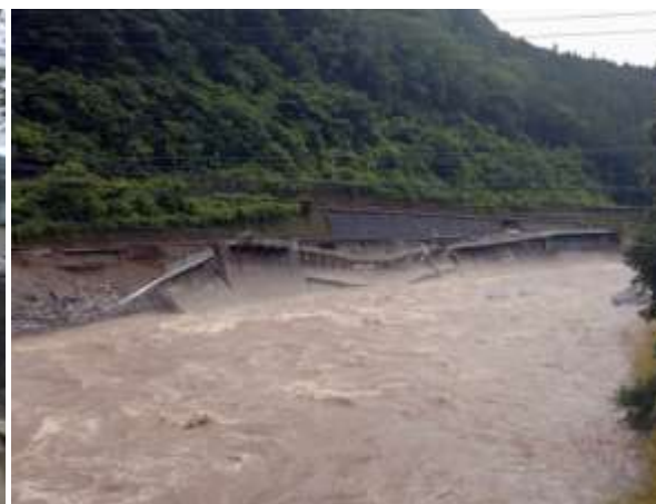
図 6-16 令和 2 年 7 月豪雨災害 (下呂市小坂町門坂地内 国道 41 号道路崩壊状況)
