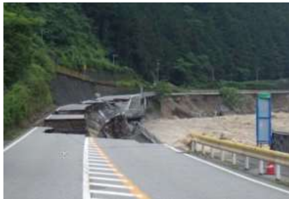
出典：岐阜県、清流の国ぎふ防災・減災センター 「令和2年7月豪雨災害検証報告書」
