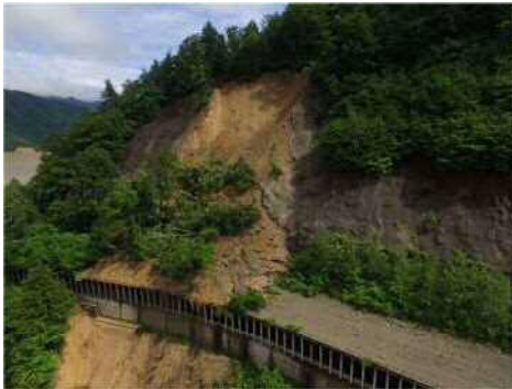
【モルタル吹付法面の崩壊（国道１５６号白川村内）】
