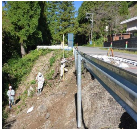
H25被災状況(路側決壊)
