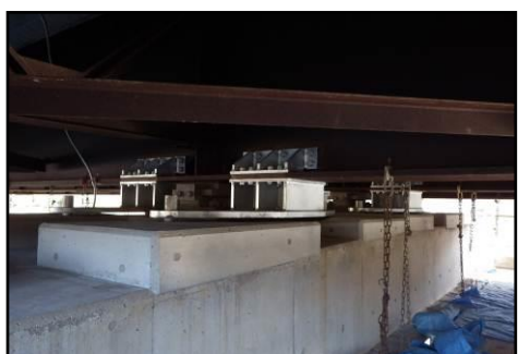
変異制限装置の設置
