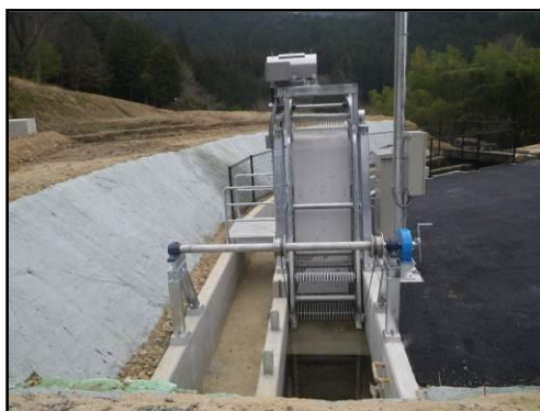
自動除塵機の設置
