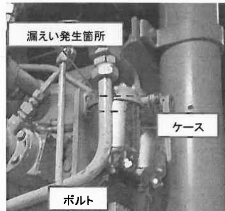
潤滑油の漏えいが確認されたストレーナ
