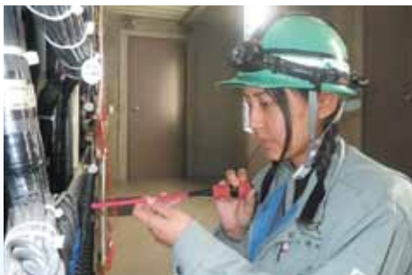
渡邊凧さんは社内で唯一の女性技術職。現場作業をする女性従業員の増加を目指し、女性用更衣室やトイレの導入も行っている。
